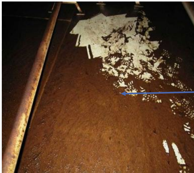
Biofilm microbien dans un bac de stockage de kérosène
