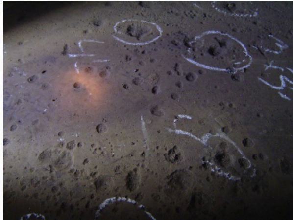
Corrosion par piqûres SRB du fond du bac
